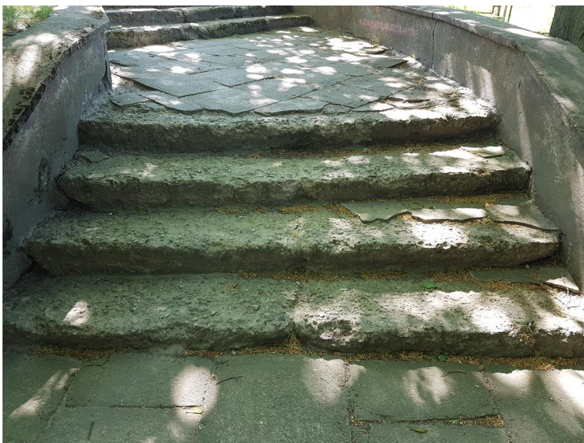
Schody zewnętrzne – uszkodzenie stopni
