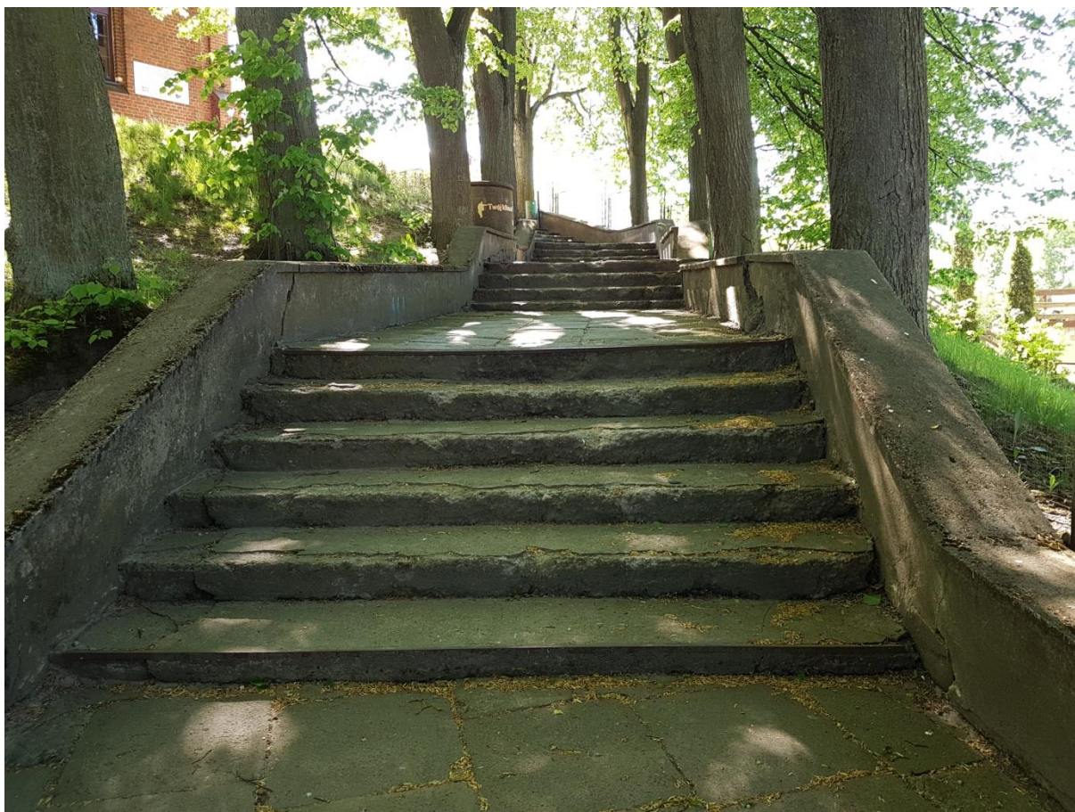
Schody zewnętrzne – uszkodzenie stopni
