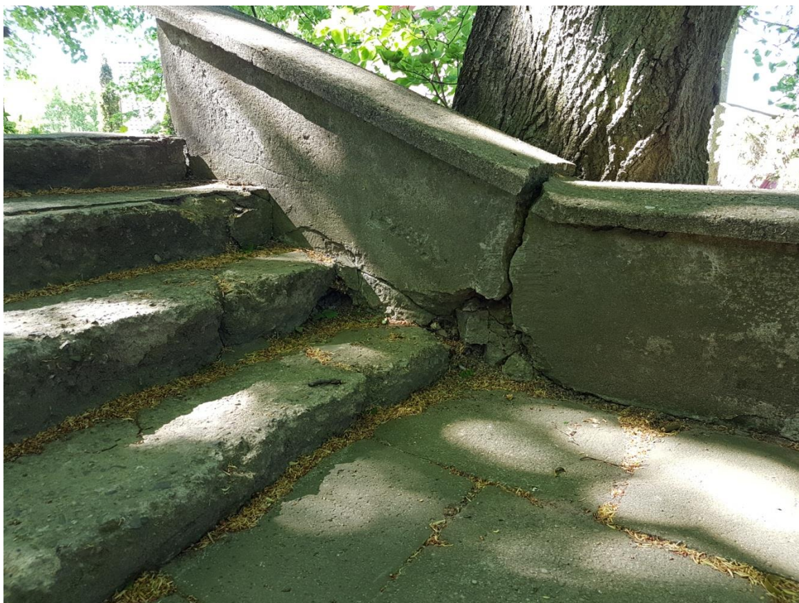
Schody zewnętrzne – uszkodzenie murku
