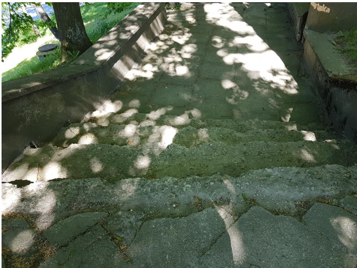
Schody zewnętrzne – uszkodzenie stopni
