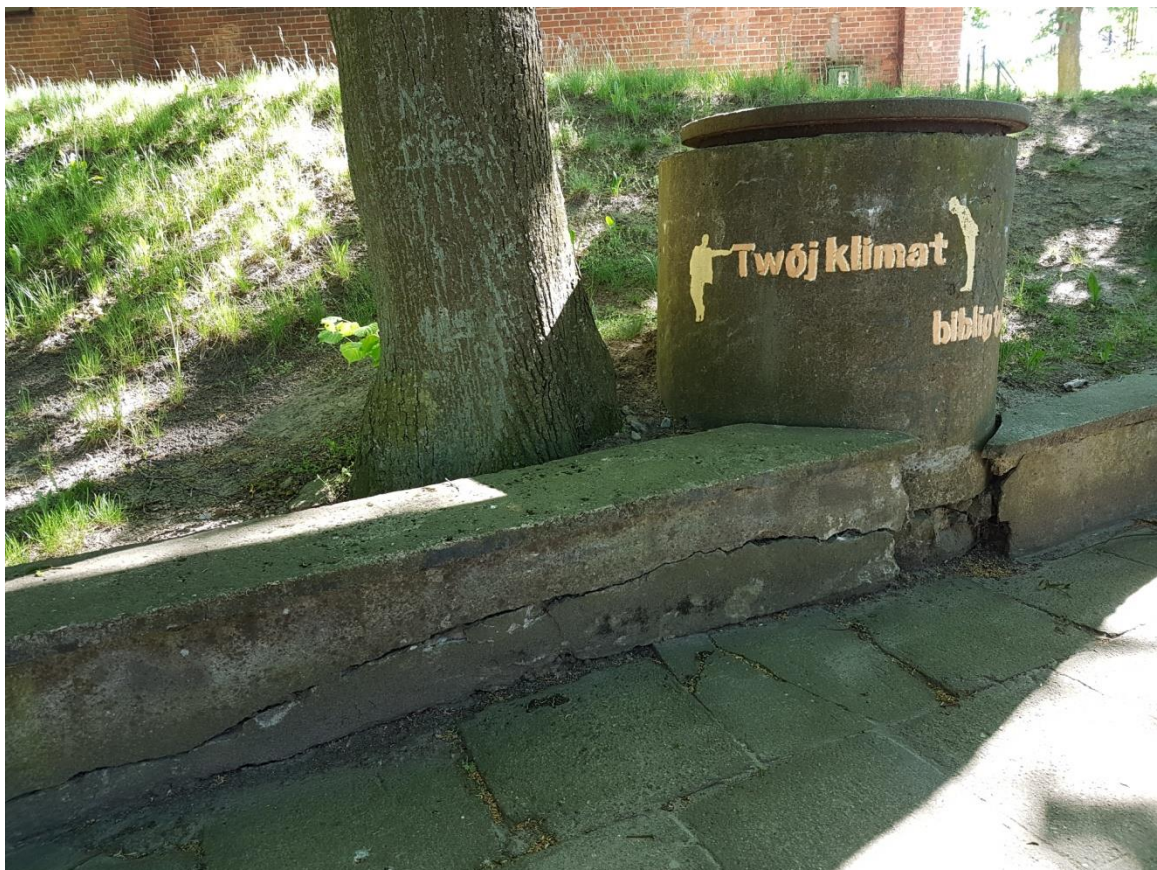
Schody zewnętrzne – uszkodzenie murku
