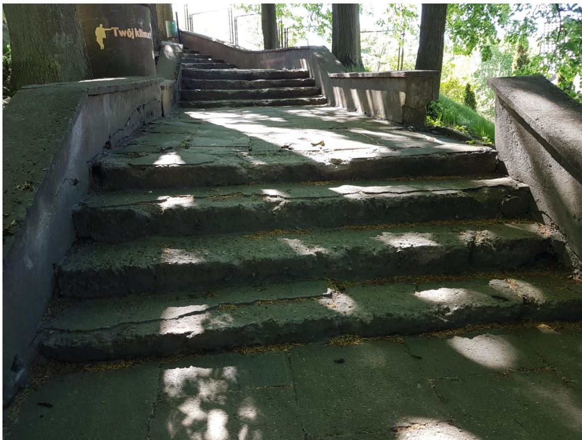
Schody zewnętrzne – uszkodzenie stopni
