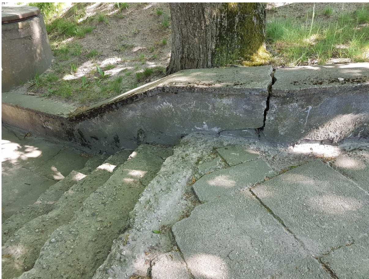
Schody zewnętrzne – uszkodzenie murku
