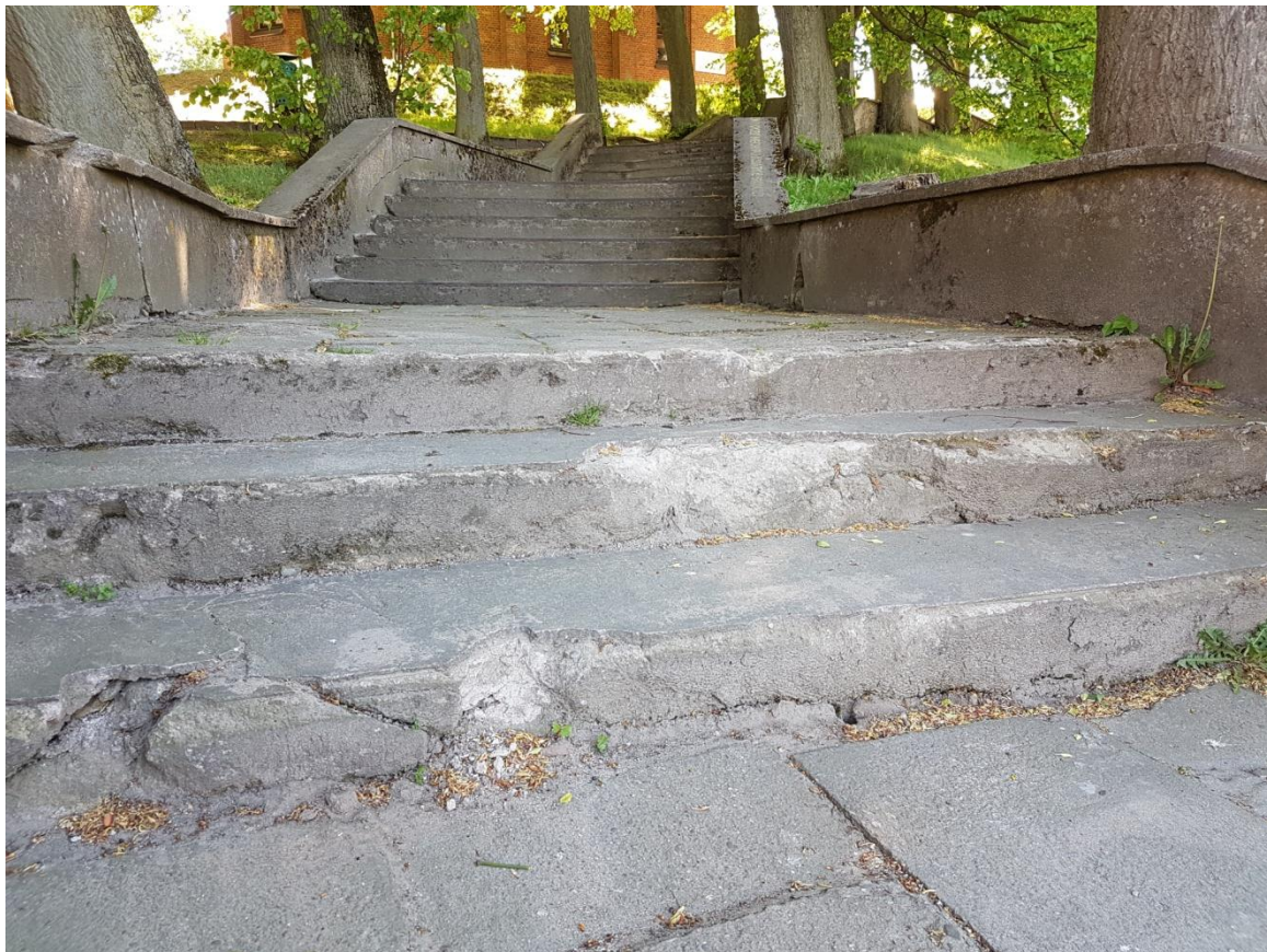
Schody zewnętrzne – uszkodzenie stopni
