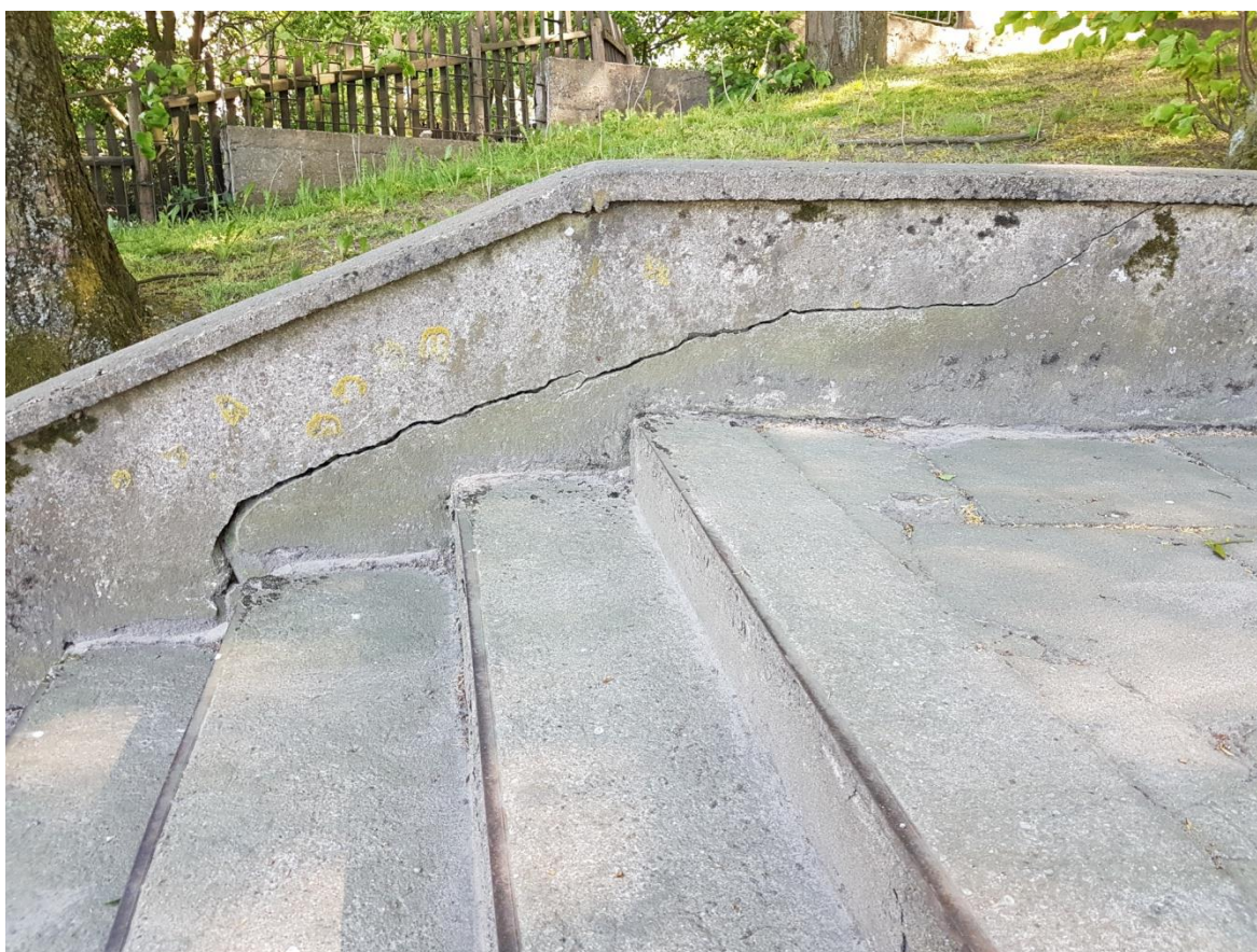
Schody zewnętrzne – uszkodzenie murku
