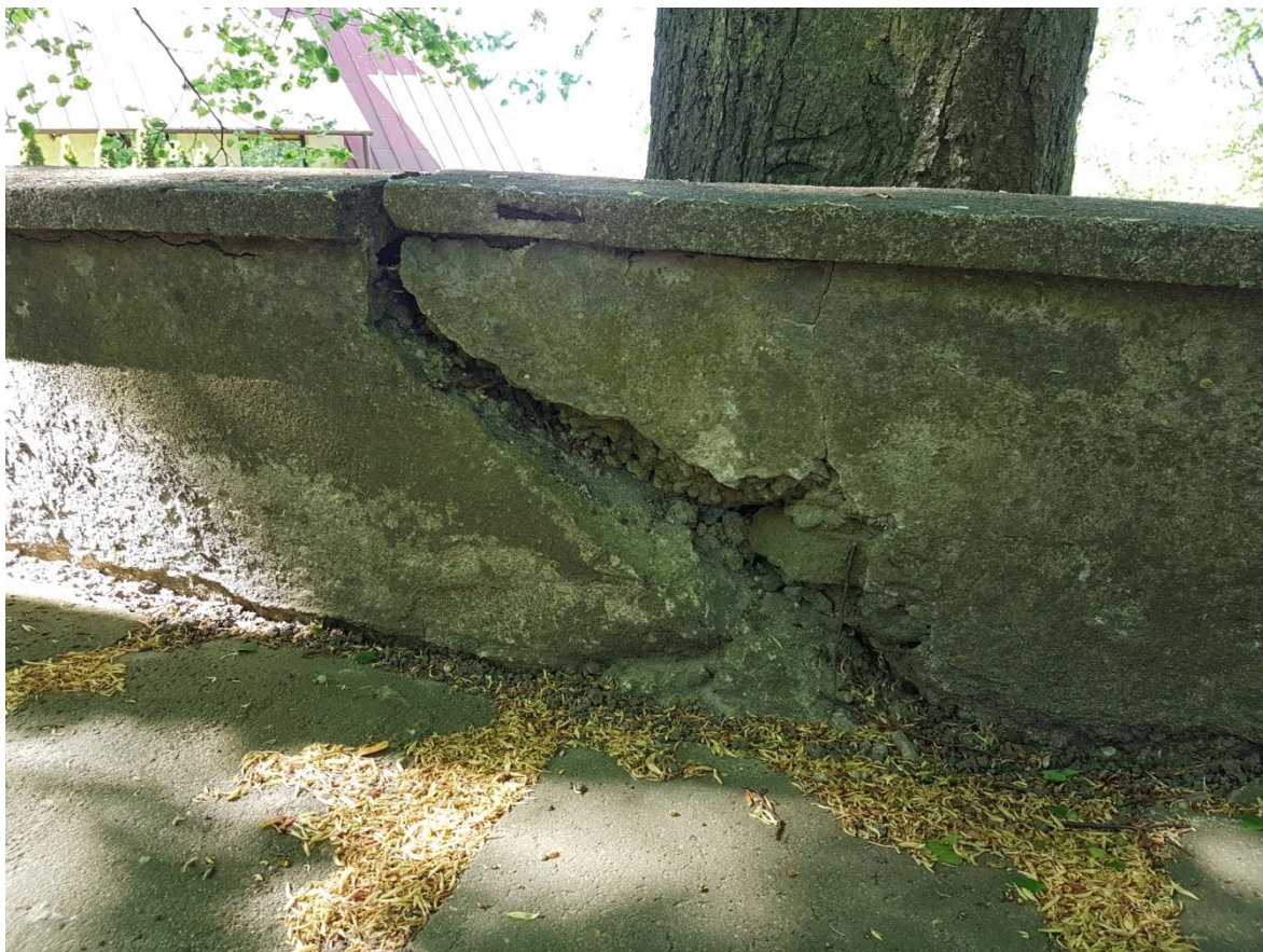
Schody zewnętrzne – uszkodzenie murku
