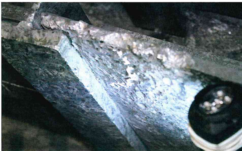
Fot.14. Widok śladów trafienia na krawędzi górnej płyty (prawdopodobnie ostrzelanej amunicją z pociskiem, posiadającym rdzeń stalowy)
