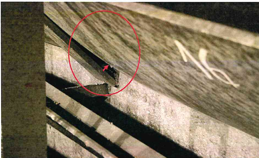
Fot.11. Odkształcenie dolnej części płyty. Ze względu na sposób podparcia łukowe odkształcenie powoduje postępujące „klawiszowanie” płyty
