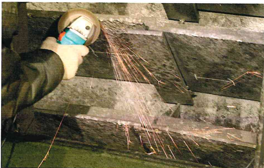
Fot.19 Próba iskrowa w miejscu zniszczeń na krawędzi płyty
