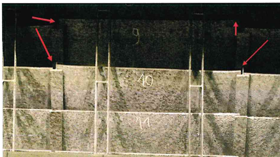
Fot.7 Widok odkształconych narożnych części płyt nr 9 i 10
