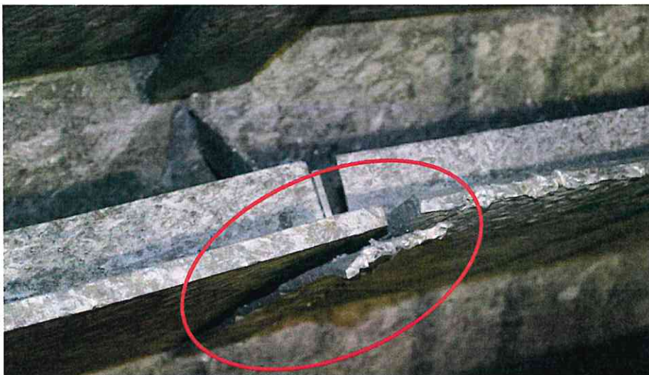
Fot.13. Widok odkształcenia wspornika, na którym powinny opierać się płyty
