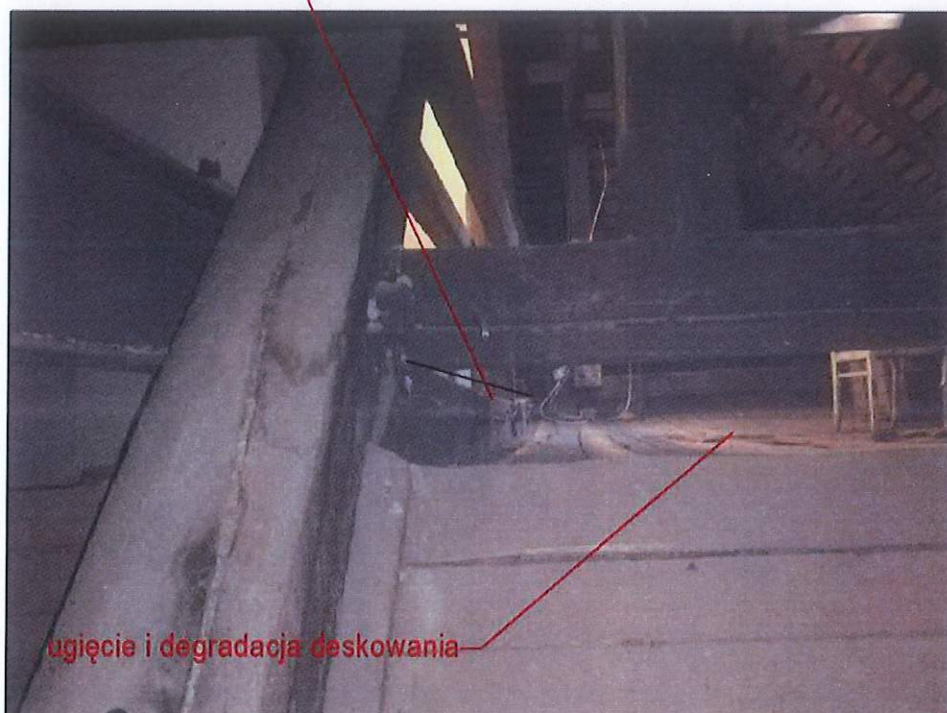
Fot. 2 – Ugięcie ramy głównej i deskowania; degradacja deskowania
