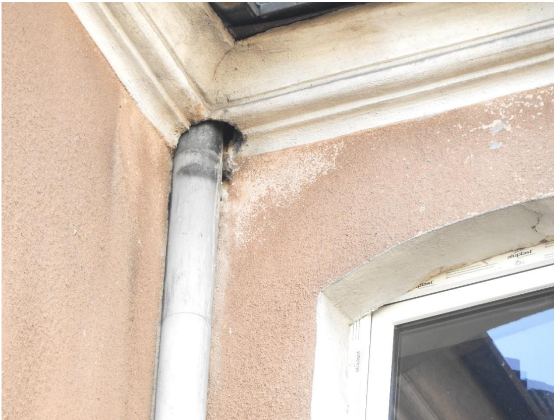
Fot. 8. Elewacja od strony podwórza, widoczne szczeliny za rynnami, w miejscu przejścia przez gzymsy.
