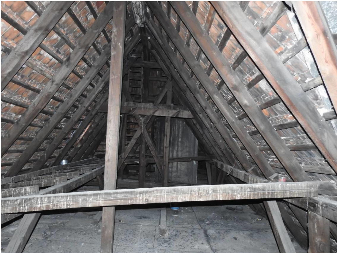
Fot. 12. Pojedyncze ślady nietoperzy w widocznej w głębi podwyższonej części strychu z drabiną.
