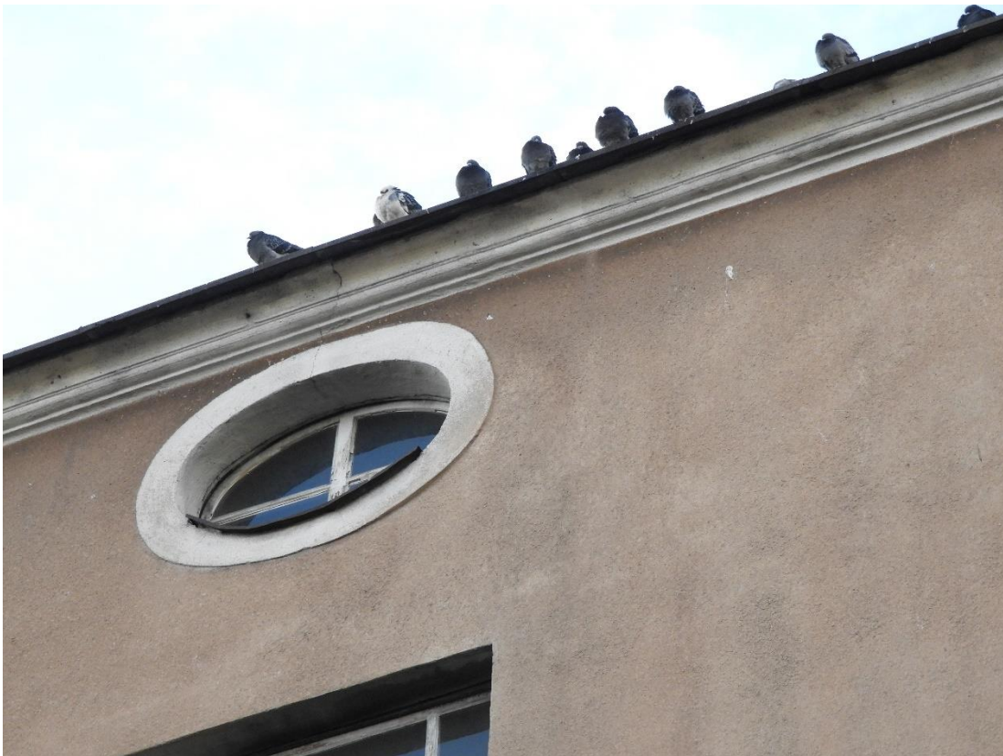
Fot. 9. Gołębie miejskie na elewacji budynku.
