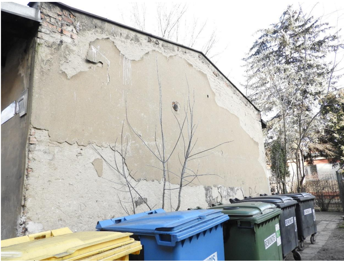
Fot. 20. Ściana szczytowa południowa brak śladów gniazdowania ptaków.
