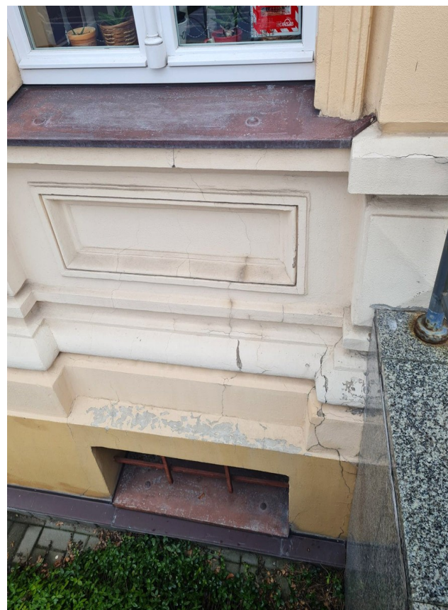
38. Budynek Biblioteki Pedagogicznej przy ul. Dąbrowskiego 4 w Toruniu. Stan zachowania na jesieni 2022 r. Elewacja frontowa. Uszkodzenia tynków w sąsiedztwie wejścia głównego. (Fot. E. Płocińska)
