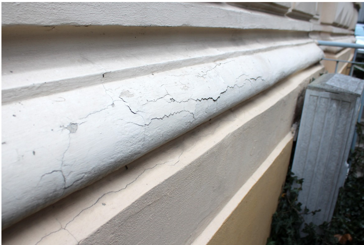
43. Budynek Biblioteki Pedagogicznej przy ul. Dąbrowskiego 4 w Toruniu. Stan zachowania na jesieni 2022 r. Elewacja boczna. Uszkodzenia tynków cokołu. (Fot. E. Płocińska)
