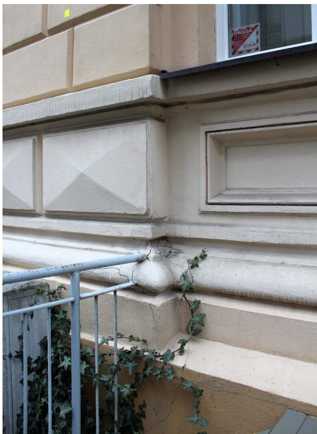
37. Budynek Biblioteki Pedagogicznej przy ul. Dąbrowskiego 4 w Toruniu. Stan zachowania na jesieni 2022 r. Elewacja boczna. Uszkodzenia tynków spowodowane prawdopodobnie korozją barierki. (Fot. E. Płocińska)
