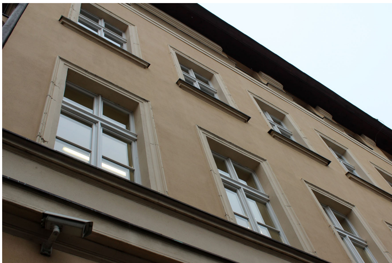
44. Budynek Biblioteki Pedagogicznej przy ul. Dąbrowskiego 4 w Toruniu. Stan zachowania na jesieni 2022 r. Elewacja tylna. Uszkodzenia profili opasek okiennych. (Fot. E. Płocińska)
