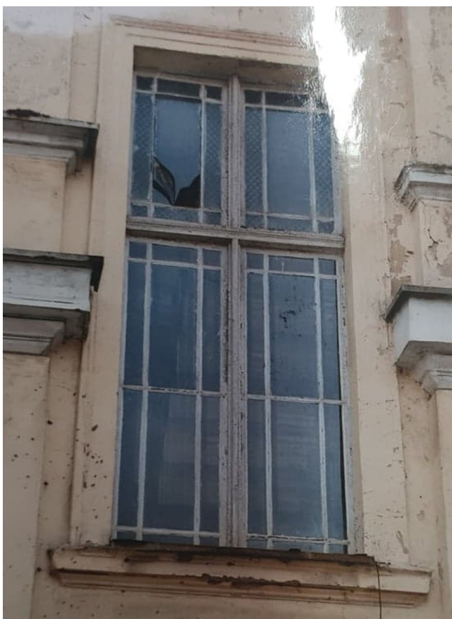
19. Budynek przy ul. Dąbrowskiego 4 w Toruniu. Elewacja tylna, okno doświetlające klatkę schodową. Stan zachowania w 2003 r. (Źródło: Karta ewidencyjna...op. cit. )
