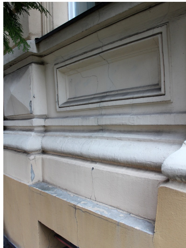
32. Budynek Biblioteki Pedagogicznej przy ul. Dąbrowskiego 4 w Toruniu. Stan zachowania na jesieni 2022 r. Elewacja frontowa. Drobne rysy w osiach otworów okiennych. (Fot. E. Płocińska)
