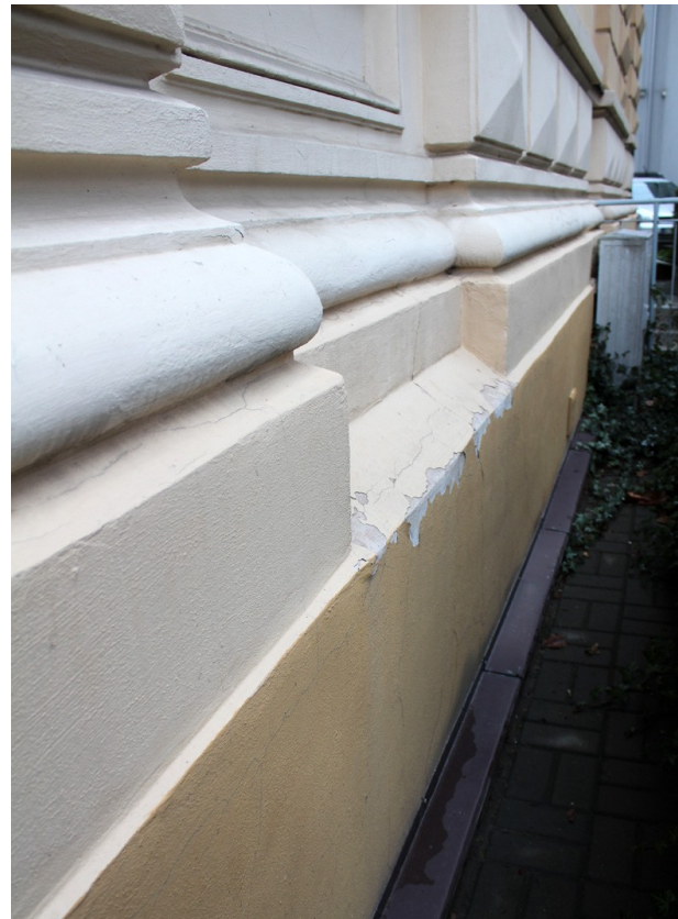
42. Budynek Biblioteki Pedagogicznej przy ul. Dąbrowskiego 4 w Toruniu. Stan zachowania na jesieni 2022 r. Elewacja boczna. Uszkodzenia tynków cokołu. (Fot. E. Płocińska)
