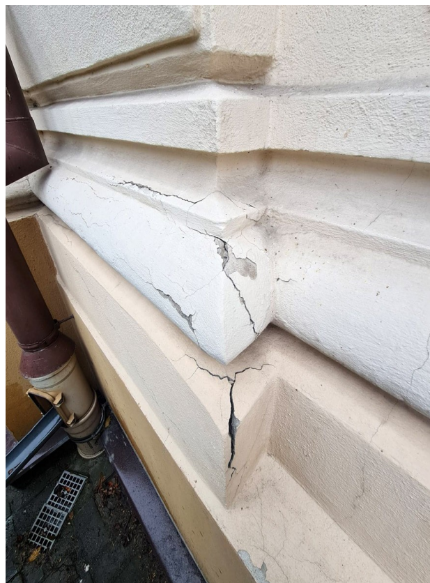
40. Budynek Biblioteki Pedagogicznej przy ul. Dąbrowskiego 4 w Toruniu. Stan zachowania na jesieni 2022 r. Elewacja frontowa. Uszkodzenia tynków w partii parteru. (Fot. E. Płocińska)
