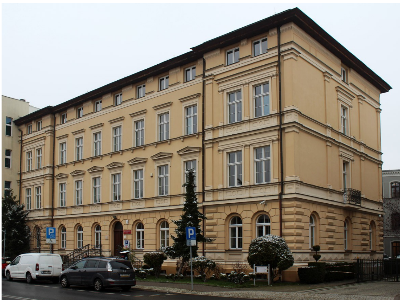
22. Budynek Biblioteki Pedagogicznej przy ul. Dąbrowskiego 4 w Toruniu. Stan zachowania na jesieni 2022 r. (Fot. E. Płocińska)
