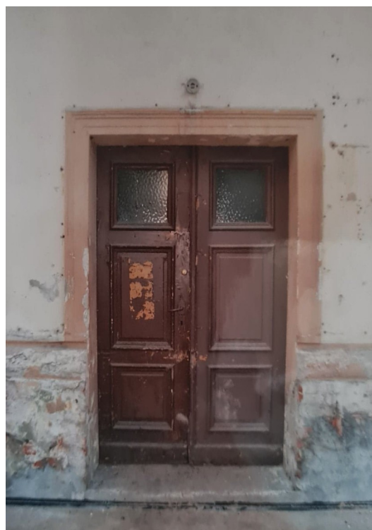
16. Budynek przy ul. Dąbrowskiego 4 w Toruniu. Elewacja tylna, wejście do klatki schodowej. Stan zachowania w 2003 r. (Źródło: Karta ewidencyjna...op. cit. )
