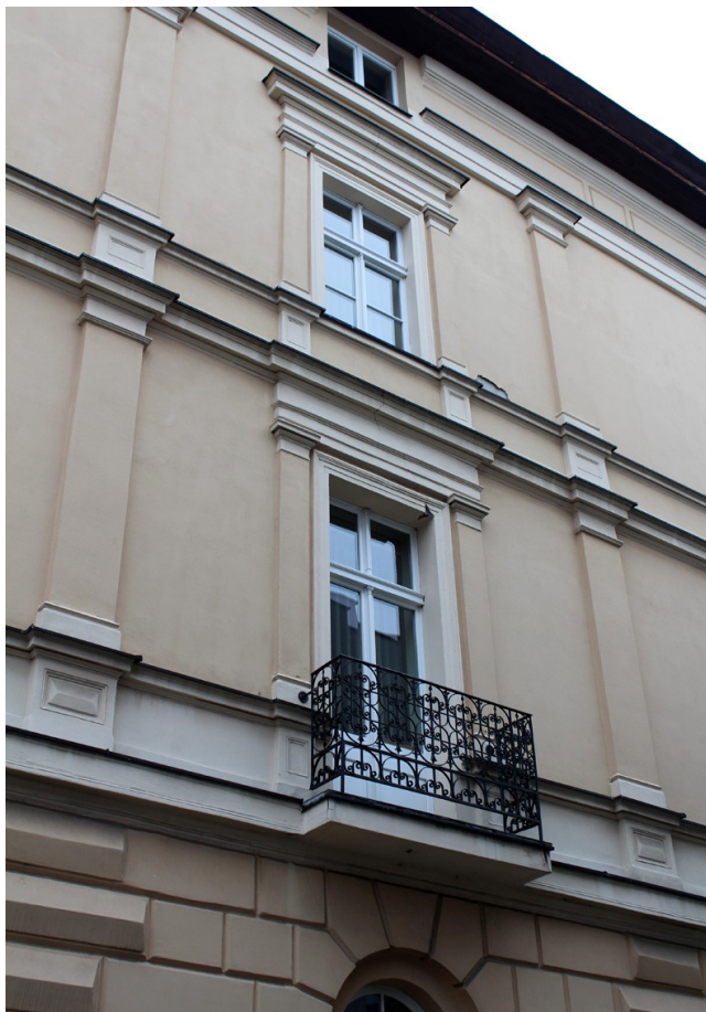
33. Budynek Biblioteki Pedagogicznej przy ul. Dąbrowskiego 4 w Toruniu. Stan zachowania na jesieni 2022 r. Elewacja boczna. Balkon. (Fot. E. Płocińska)
