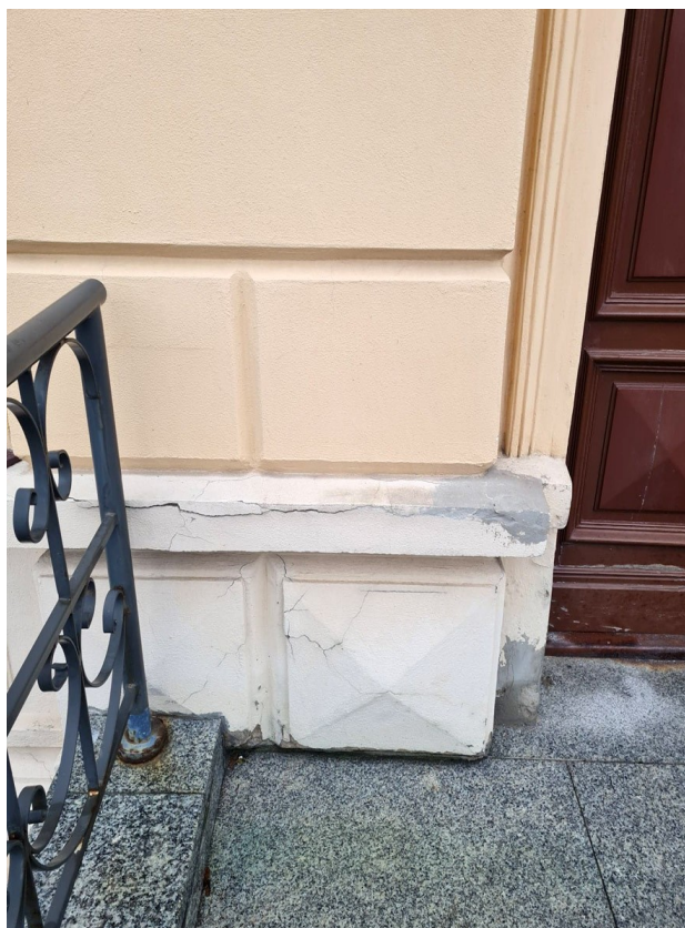
41. Budynek Biblioteki Pedagogicznej przy ul. Dąbrowskiego 4 w Toruniu. Stan zachowania na jesieni 2022 r. Elewacja frontowa. Uszkodzenia tynków w sąsiedztwie wejścia głównej. (Fot. E. Płocińska)
