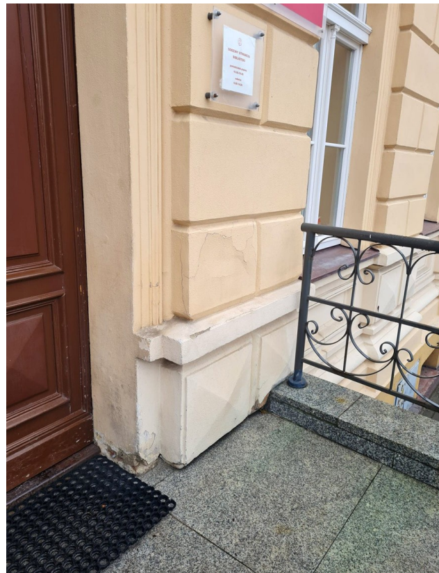
36. Budynek Biblioteki Pedagogicznej przy ul. Dąbrowskiego 4 w Toruniu. Stan zachowania na jesieni 2022 r. Elewacja frontowa. Rozwarstwienia tynków przy wejściu głównym. (Fot. E. Płocińska)
