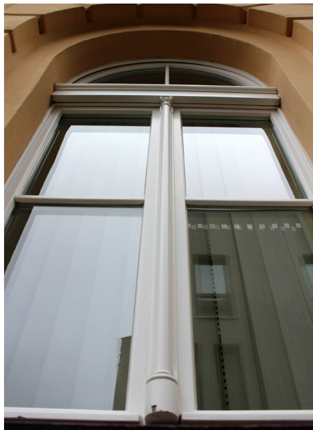
30. Budynek Biblioteki Pedagogicznej przy ul. Dąbrowskiego 4 w Toruniu. Stan zachowania na jesieni 2022 r. Wtórna stolarka okienna. (Fot. E. Płocińska)
