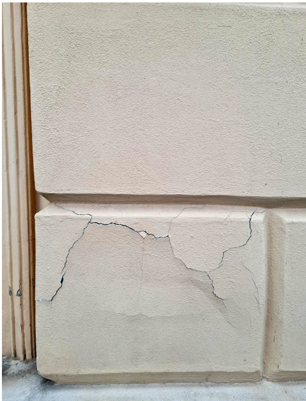
35. Budynek Biblioteki Pedagogicznej przy ul. Dąbrowskiego 4 w Toruniu. Stan zachowania na jesieni 2022 r. Spękania tynków w partii tynków boniowań. (Fot. E. Płocińska)
