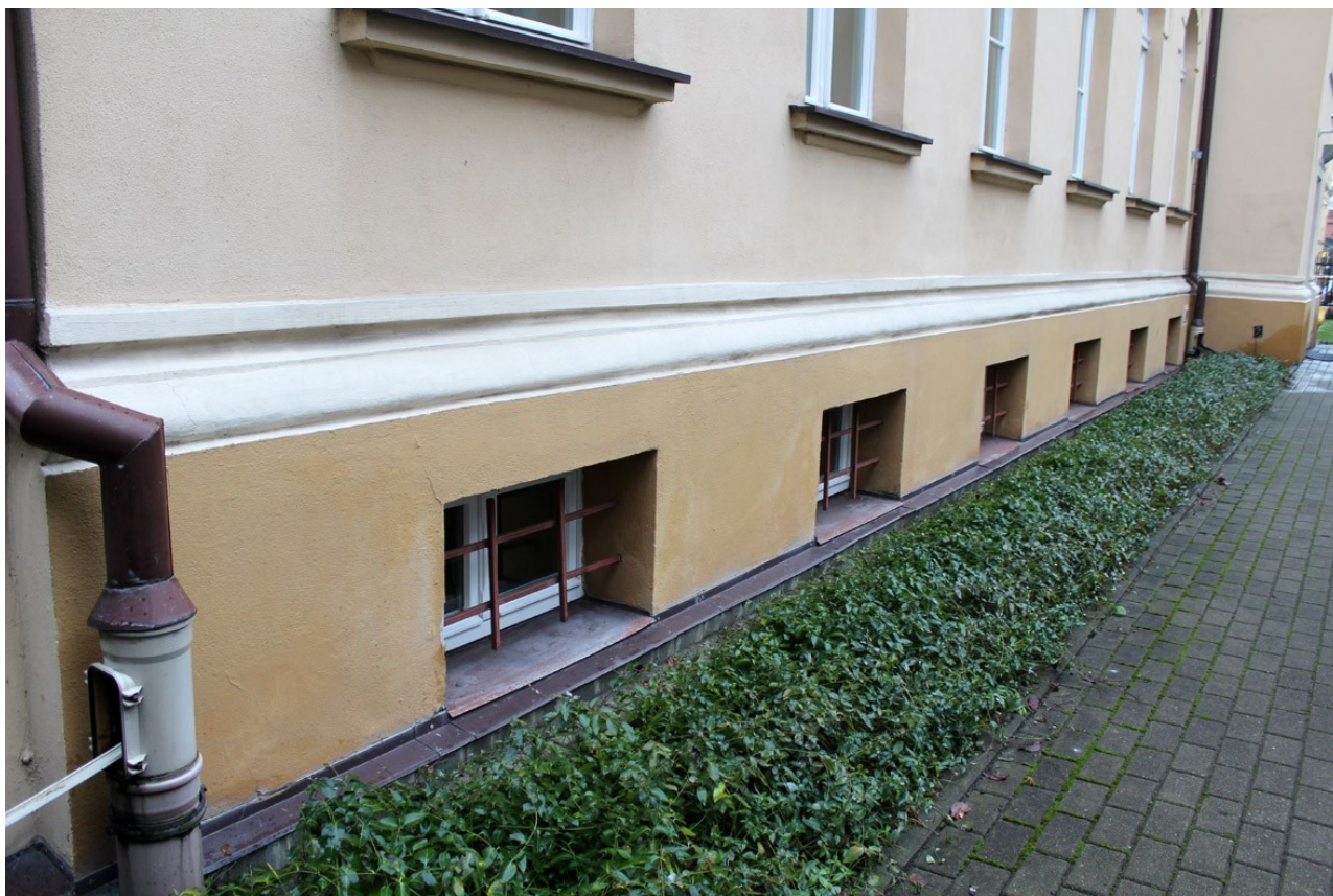
53. Budynek Biblioteki Pedagogicznej przy ul. Dąbrowskiego 4 w Toruniu. Jesień 2022 r. Stan zachowania instalacji przeciwwodnej. (Fot. E. Płocińska)
