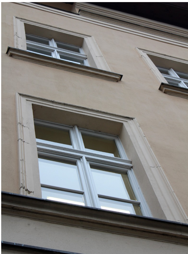
45. Budynek Biblioteki Pedagogicznej przy ul. Dąbrowskiego 4 w Toruniu. Stan zachowania na jesieni 2022 r. Elewacja tylna. Uszkodzenia profili opasek okiennych. (Fot. E. Płocińska)
