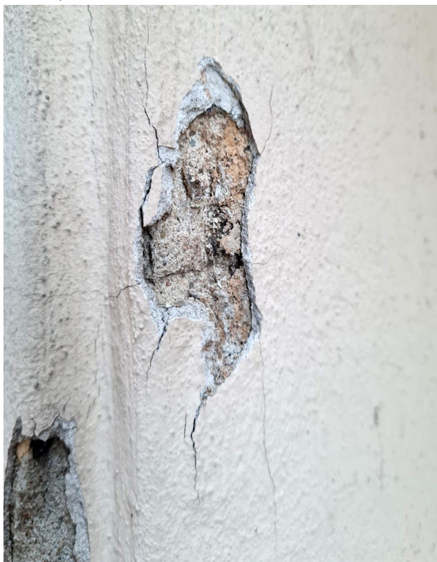
48. Budynek Biblioteki Pedagogicznej przy ul. Dąbrowskiego 4 w Toruniu. Stan zachowania na jesieni 2022 r. Rozwarstwienia tynku. Szczelna powłoka cienkowarstwowa na tynkach o niższej wytrzymałości z powłoką malarską w kolorze ugrowym. (Fot. E. Płocińska)
