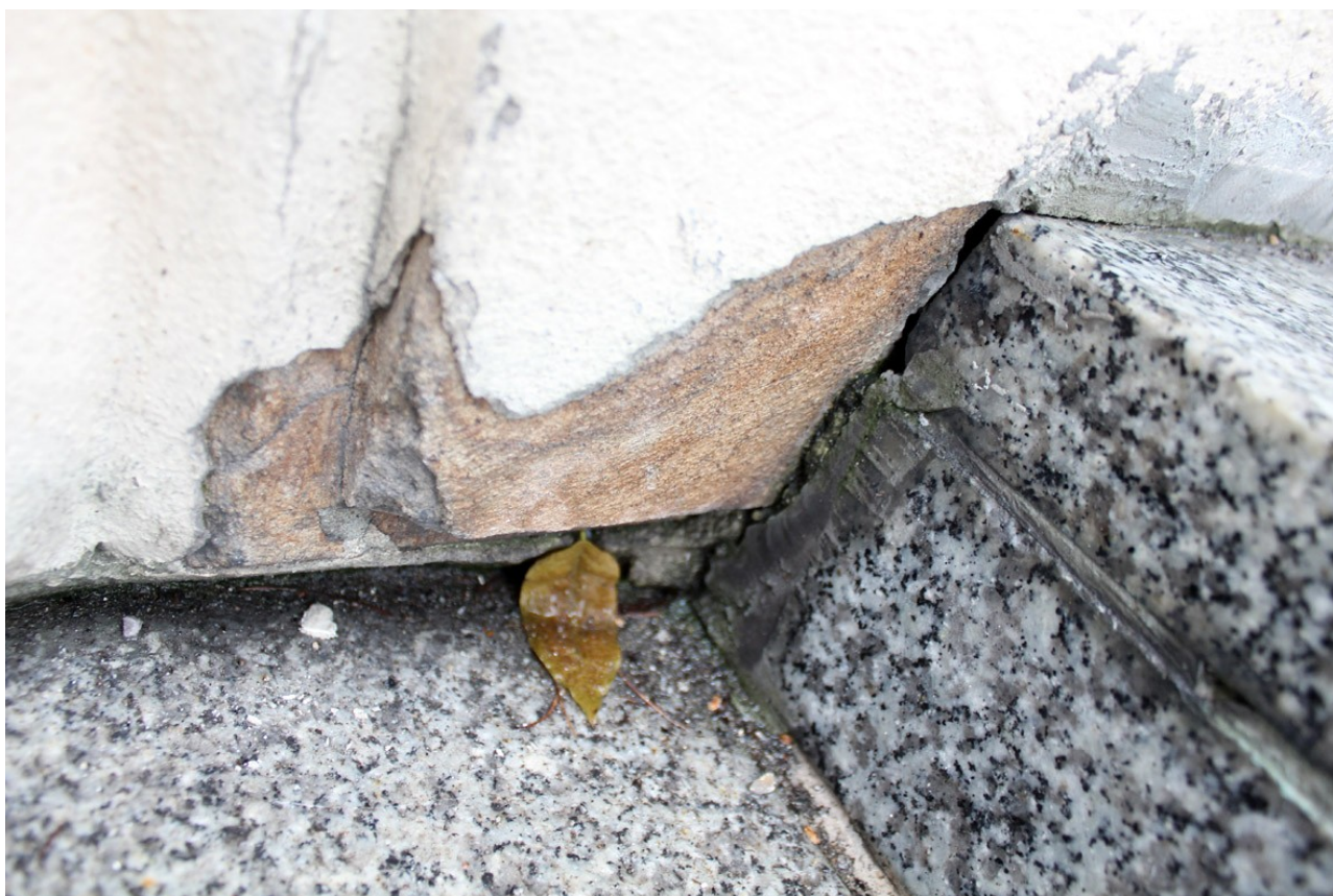
50. Budynek Biblioteki Pedagogicznej przy ul. Dąbrowskiego 4 w Toruniu. Stan zachowania na jesieni 2022 r. Rozwarstwienia tynku. Szczelna powłoka cienkowarstwowa na tynkach o niższej wytrzymałości z powłoką malarską w kolorze ugrowym. (Fot. E. Płocińska)
