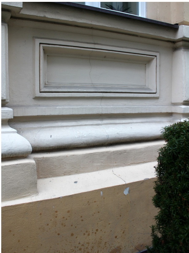
31. Budynek Biblioteki Pedagogicznej przy ul. Dąbrowskiego 4 w Toruniu. Stan zachowania na jesieni 2022 r. Elewacja boczna. Drobne rysy w osiach otworów okiennych. (Fot. E. Płocińska)
