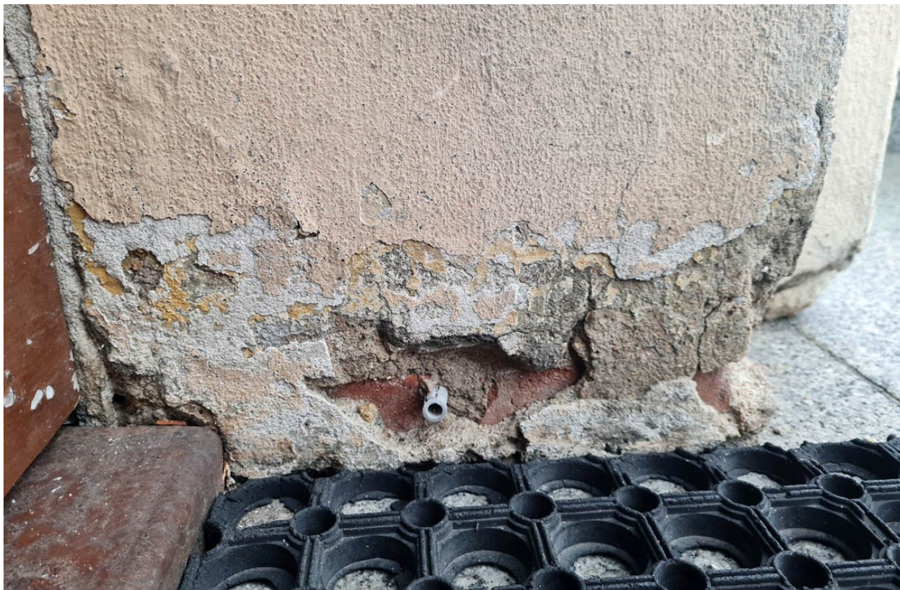
49. Budynek Biblioteki Pedagogicznej przy ul. Dąbrowskiego 4 w Toruniu. Stan zachowania na jesieni 2022 r. Rozwarstwienia tynku. Szczelna powłoka cienkowarstwowa na tynkach o niższej wytrzymałości z powłoką malarską w kolorze ugrowym. (Fot. E. Płocińska)
