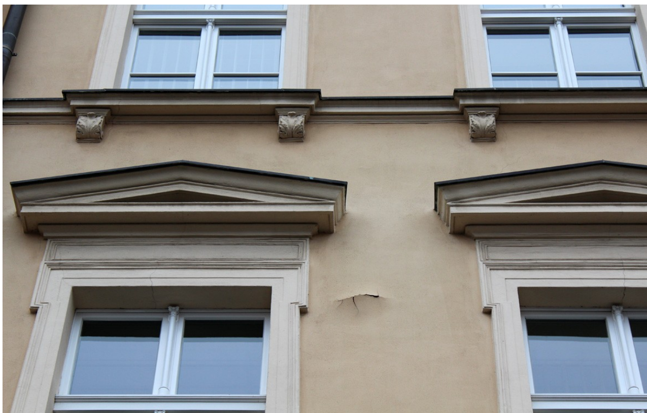
34. Budynek Biblioteki Pedagogicznej przy ul. Dąbrowskiego 4 w Toruniu. Stan zachowania na jesieni 2022 r. Elewacja frontowa. Pęcherz w partii tynków płaskich. (Fot. E. Płocińska)
