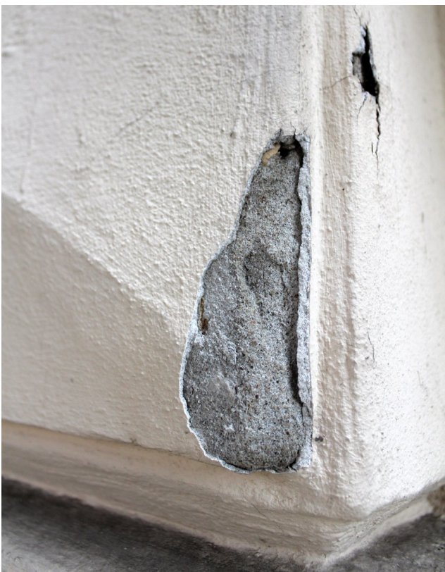
47. Budynek Biblioteki Pedagogicznej przy ul. Dąbrowskiego 4 w Toruniu. Stan zachowania na jesieni 2022 r. Rozwarstwienia tynku. Szczelna powłoka cienkowarstwowa na tynkach o niższej wytrzymałości. (Fot. E. Płocińska)
