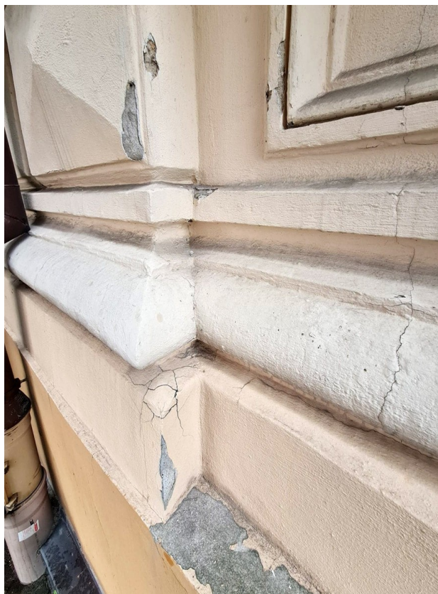
39. Budynek Biblioteki Pedagogicznej przy ul. Dąbrowskiego 4 w Toruniu. Stan zachowania na jesieni 2022 r. Elewacja frontowa. Uszkodzenia tynków w partii parteru. (Fot. E. Płocińska)
