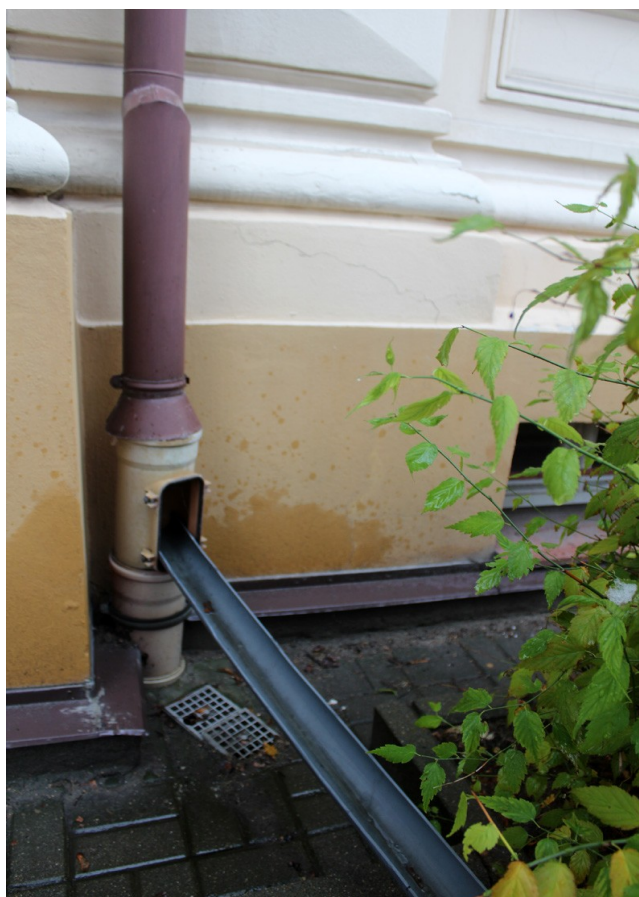
55, 56, 57. Budynek Biblioteki Pedagogicznej przy ul. Dąbrowskiego 4 w Toruniu. Jesień 2022 r. Stan zachowania instalacji przeciwwodnej. (Fot. E. Płocińska)
