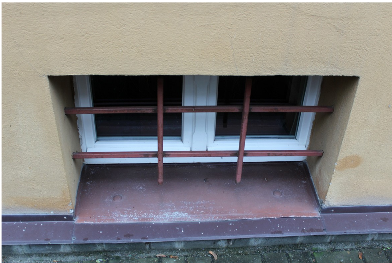
54. Budynek Biblioteki Pedagogicznej przy ul. Dąbrowskiego 4 w Toruniu. Jesień 2022 r. Stan blacharki i rozwiązanie izolacji. (Fot. E. Płocińska)
