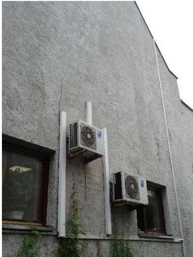
Fot. 14 Klimatyzatory na elewacji południowej do demontażu i ukrycia za nowoprojektowaną obudową.
