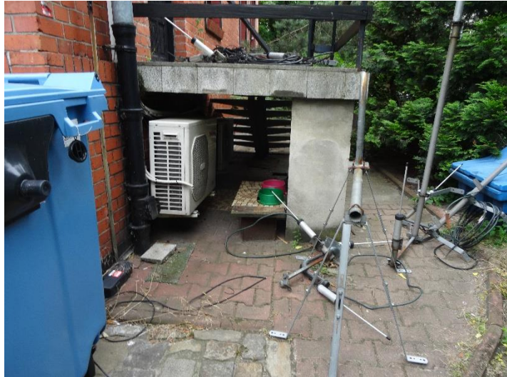
Fot. 15 Jednostki klimatyzacyjne pod schodami, które zostaną wyburzone.
