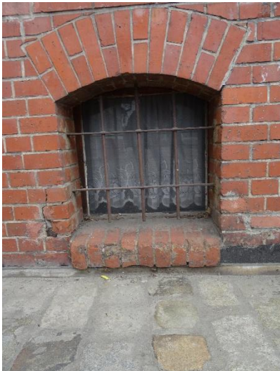
Zdj. 2. Ubytki w ceglach w obrębie cokołu oraz parapetu okienka piwnicznego.
