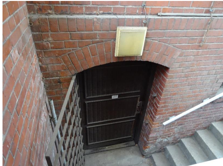
Zdj. 3. Ubytki w ceglach w obrębie wejścia do części budynku zlokalizowanej poniżej poziomu terenu.
