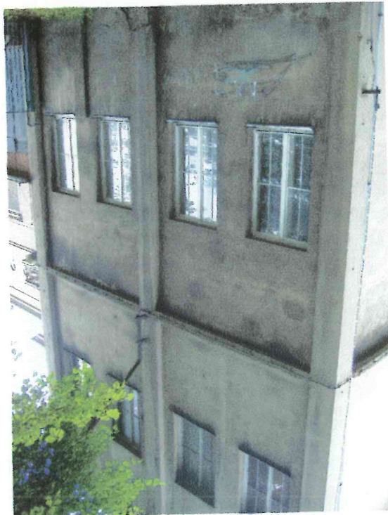
Fot. 11 Ogólnie zły stan zachowania bocznej, tynkowanej elewacji
