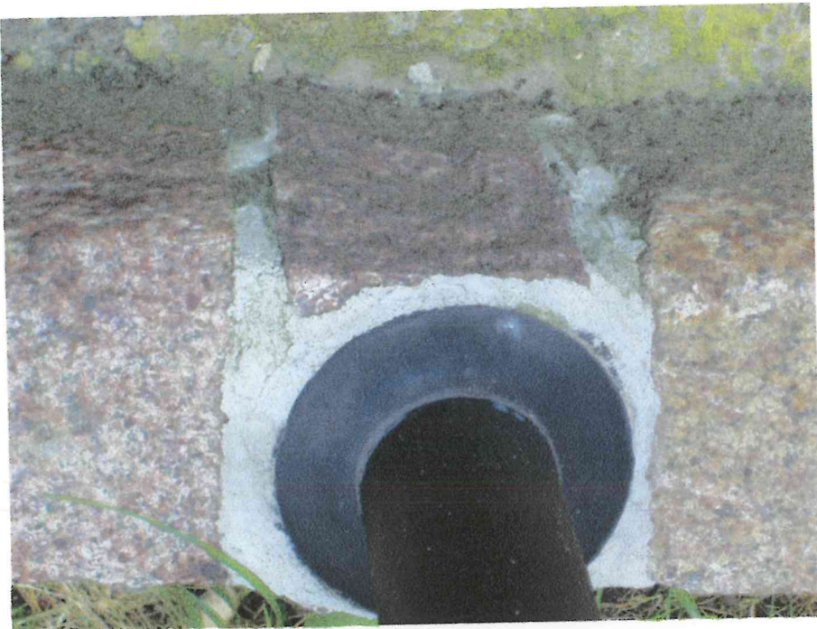
Fot. 8 Spoiny w murku granitowym
