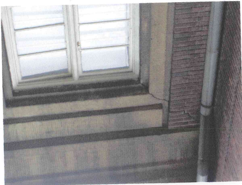
Fot.2. Naloty w partii tynkowanej – tu okiennej.
