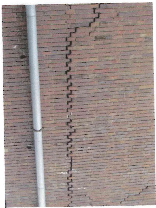
Fot. 7 Silne spękanie muru.
