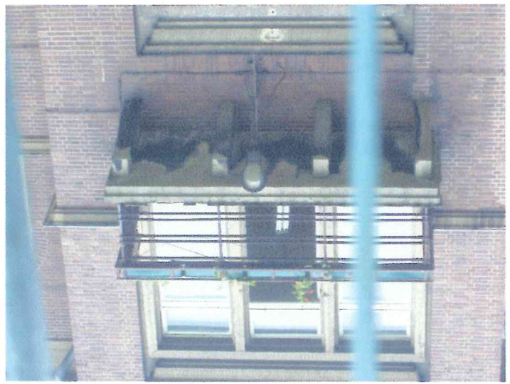
Fot.13 Balkon w elewacji tylnej-zawilgozcenia, zasolenia.
