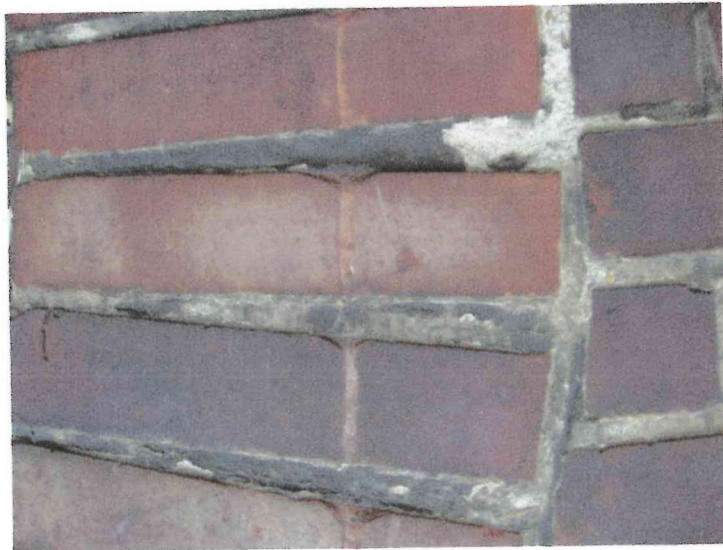
Fot.9 Czarne naloty soli gipsowych na spoinie.
