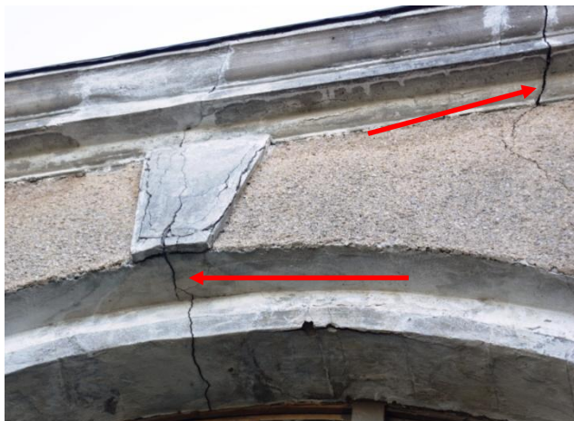
Fot. nr 20. Pęknięcie nadproża okiennego.
