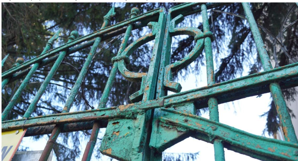
Fot. nr 17. Fragment stalowej bramy z widocznymi śladami korozji pod łuszczącą się warstwą farby.
