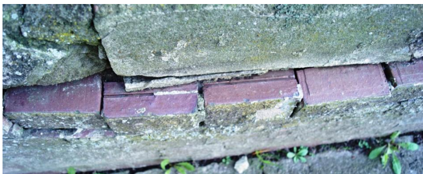
Fot. nr 13. Widoczne odspajanie się klinkierowej okładziny cokołu, fragment od ul. Zagórskiej.
