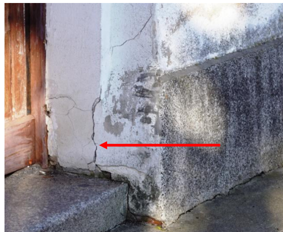
Fot. nr 21. Pęknięcia występujące w partii cokołowej.
