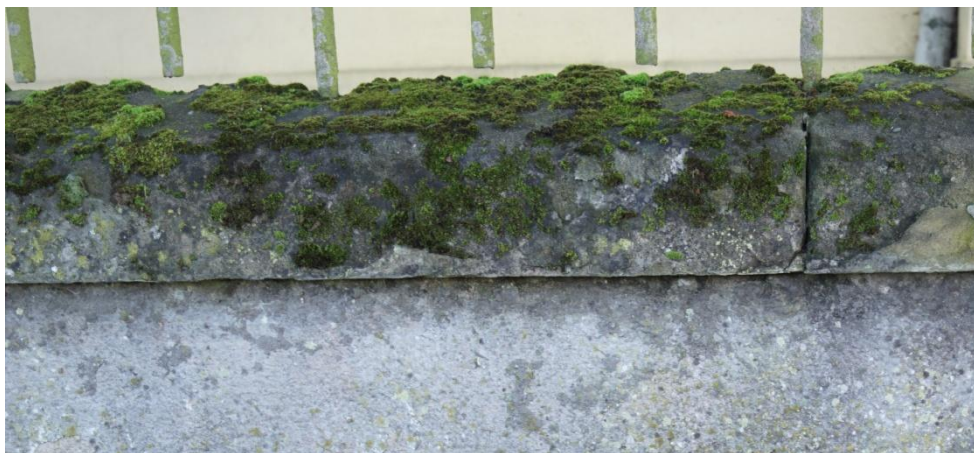
Fot. nr 16. Widoczne plechy porostów na nakrywie cokołu.
