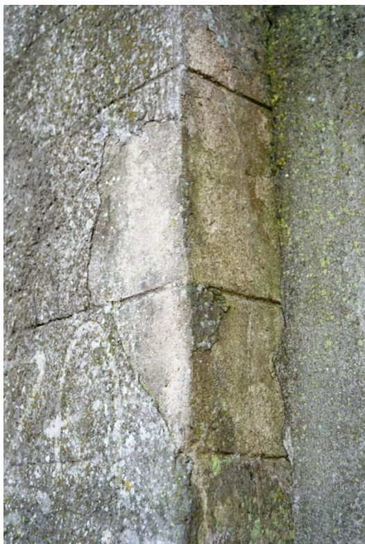
Fot. nr 11. Fotografia dokumentująca zachowane warstwy pierwotnego tynku z boniowaniem powierzchni.
