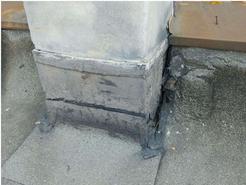
Zdjęcie 12 Komin w części południowej. Nieszczelności na styku z pokryciem z papy.
