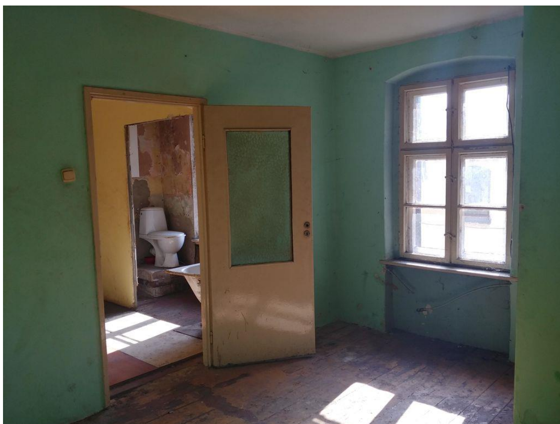
Zdjęcie 43 To mieszkanie nie spełnia żadnych standardów. Nie mniej jednak zaleca się podjąć próbę wyremontowania budynku i selektywnie dobierać lokatorów w czasie jego zasiedlania.
