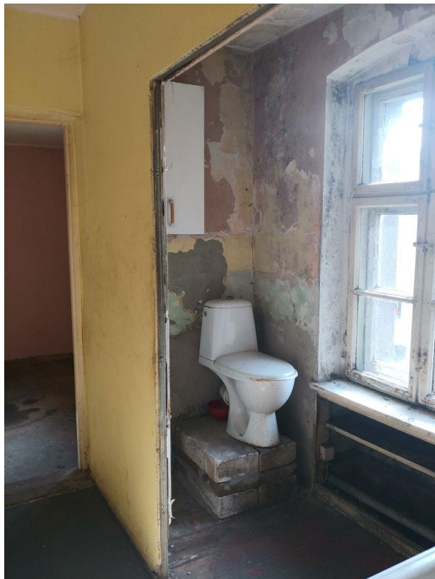
Zdjęcie 39 ... wraz z ubikacją. W mieszkaniu nie ma wentylacji.
