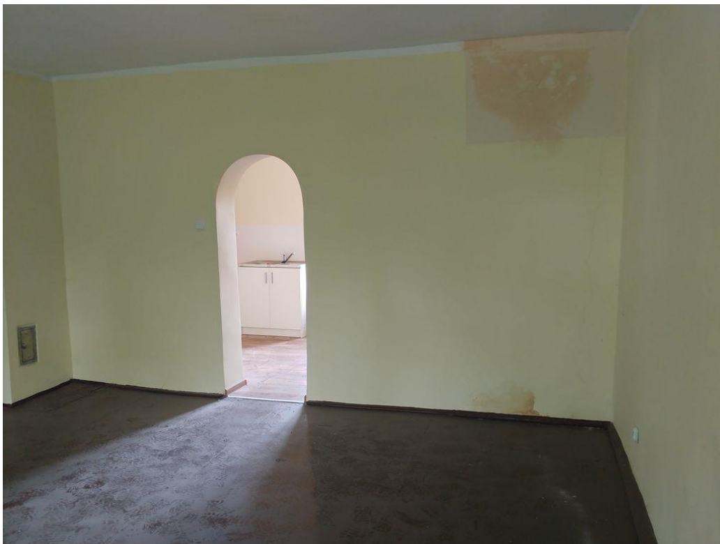
Zdjęcie 33 Mieszkanie na piętrze w zachodniej części budynku z wyraźnymi śladami zalania.
