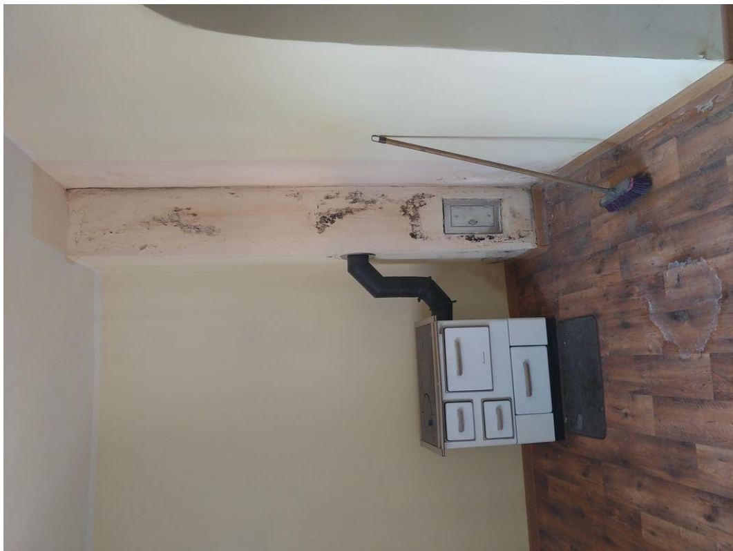
Zdjęcie 34 Mieszkanie jw. - kuchnia. Zalanie spowodowało powstanie kałuży. Obudowę przewodu kominowego należy wymienić.
