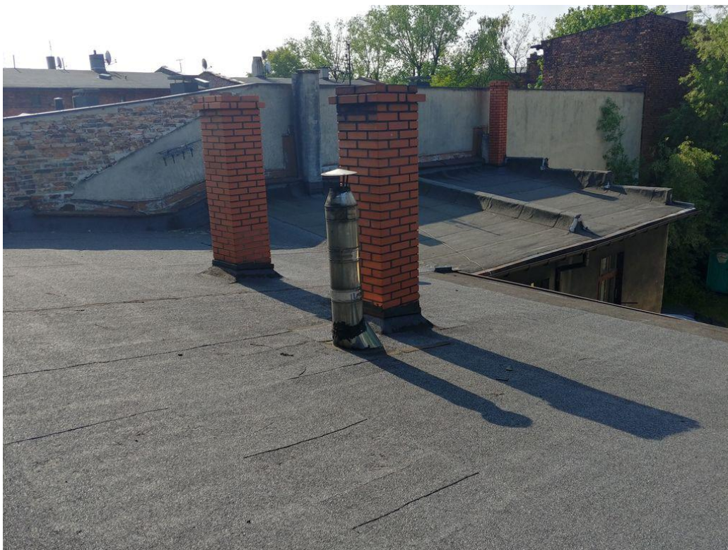
Zdjęcie 3 Pokrycie nad południową częścią budymku. Widok ogólny. Nowe kominy i obróbki nie budzą zastrzeżeń w zakresie jakości wykonania.
