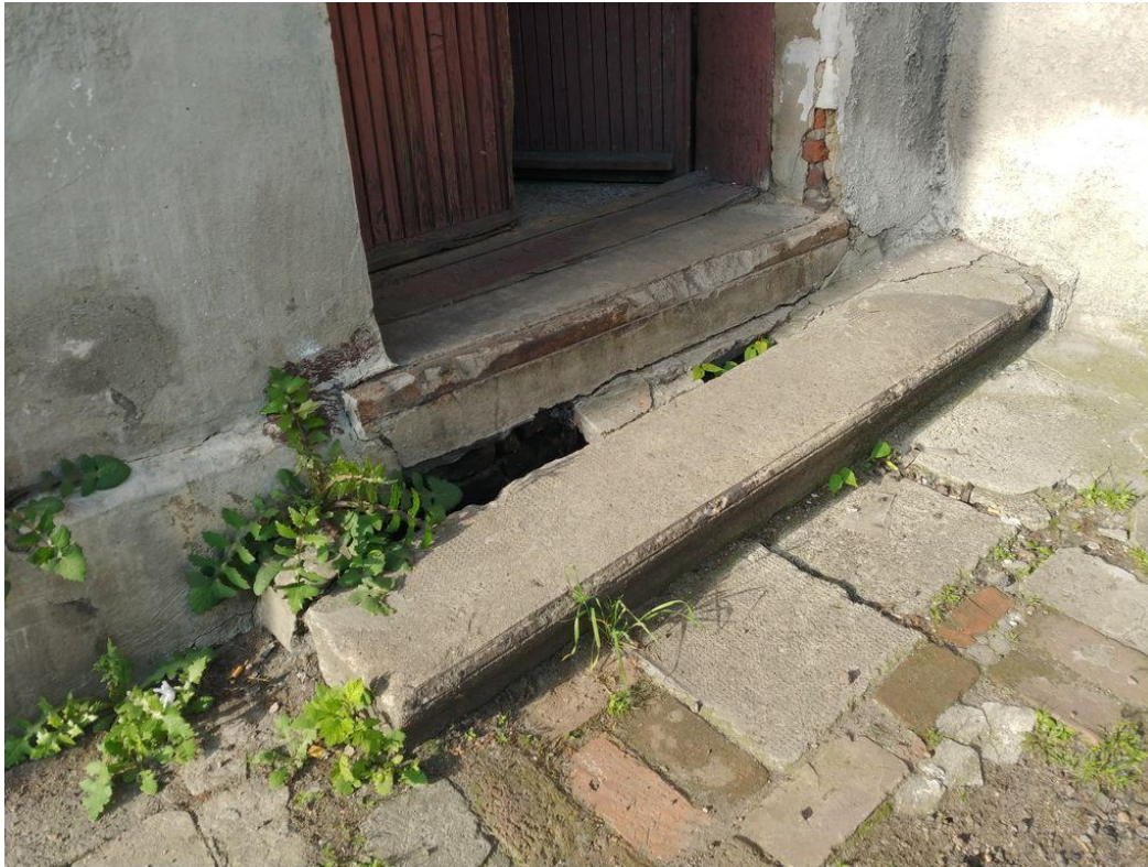
Zdjęcie 15 Stopień przed wejściem do budynku wymaga naprawy.
