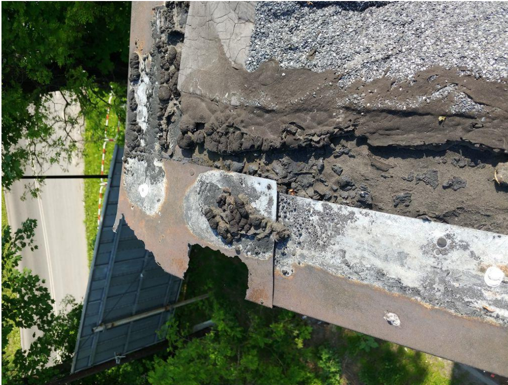
Zdjęcie 9 Skorodowane obróbki blacharskie w północno – zachodnim narożu budynku.
