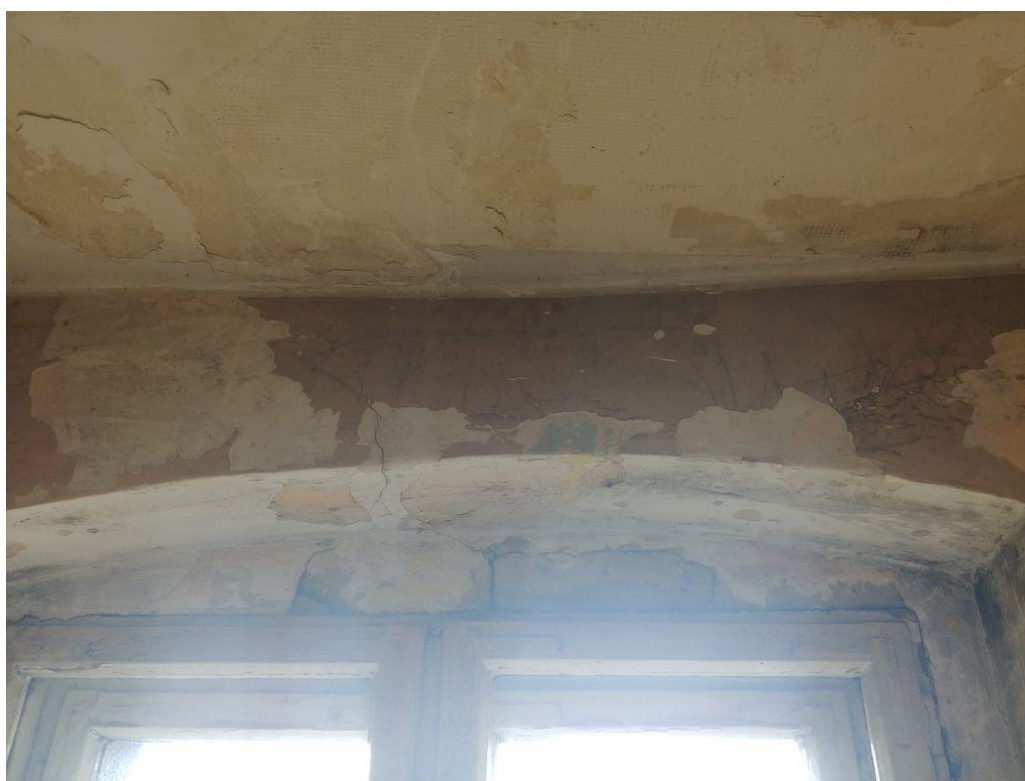
Zdjęcie 41 Zarysowane nadproże okienne oraz tynk wymagający naprawy.
