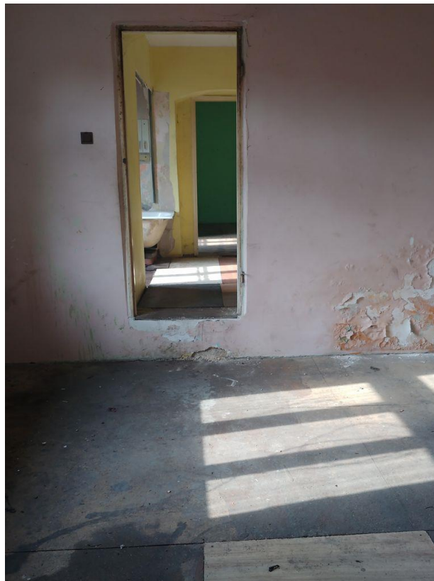
Zdjęcie 40 Różnica poziomów pomiędzy pokojami. Tynki wymagają naprawy poprzez ich wymianę. Zdjęcie zrobiono w pokoju nad pustostanem z osobnym wejściem.
