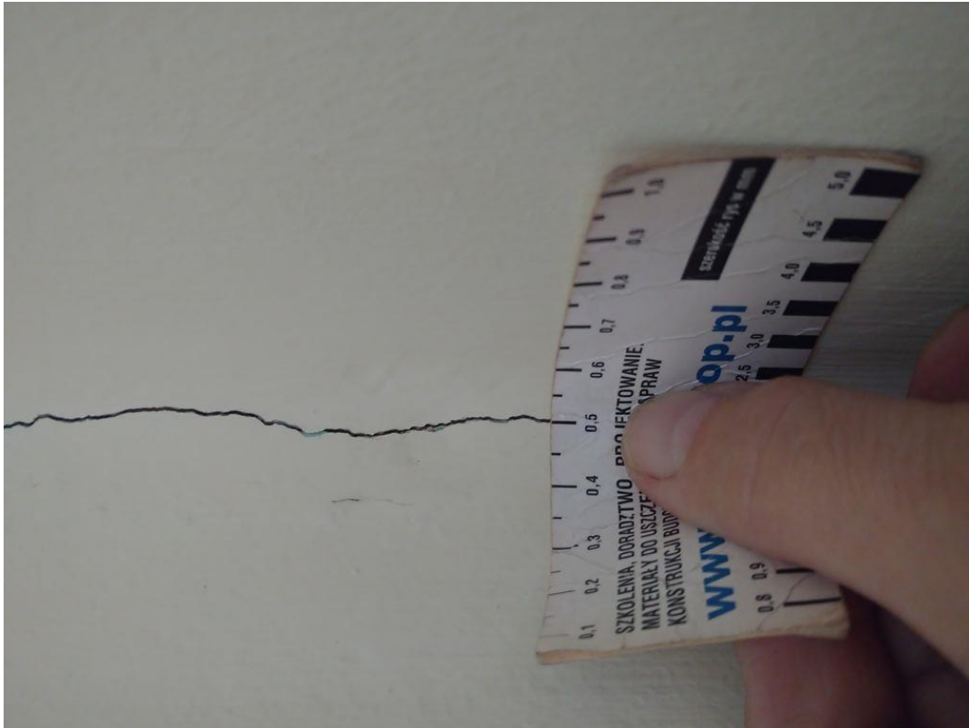
Zdjęcie 35 Pęknięcie zachodniej ściany szczytowej widoczne w pokoju.
