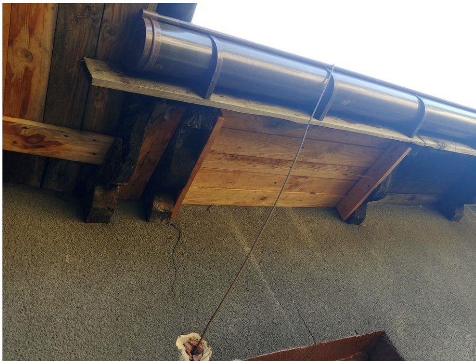
Zdjęcie 13, 14 Podbitka z desek bezpośrednio pod dziurą w pokryciu papowym, mocowana pomiędzy belkami krokwiowymi zamiast na nich.
