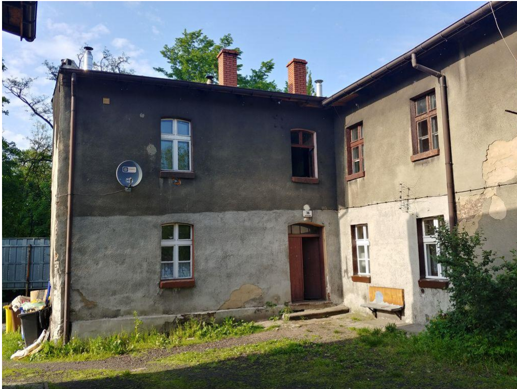
Zdjęcie 21 Pozostałe elewacje: zaleca się wymianę wszystkich tynków oraz przeprowadzenie termomodernizacji obiektu.
