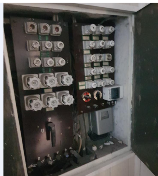
Istniejąca rozdzielnica elektryczna na klatce schodowej
