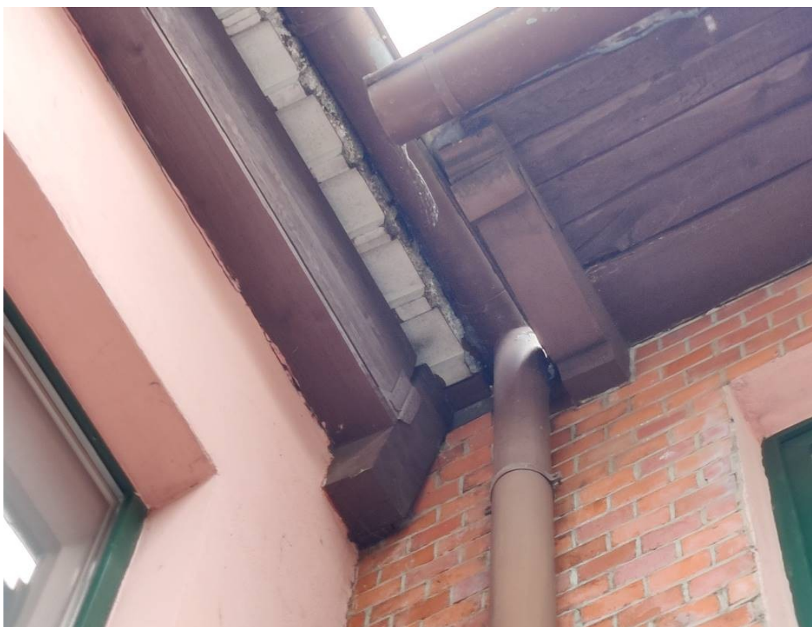
Zdjęcie nr 3.21 Zdjęcie elewacji wewnętrznej – połączenie budynku „A” z budynkiem „B” – przewidzianym do rozbiórki – widoczne rozdzielne konstrukcje dachu – brak widocznej dylatacji – zasłonięta styropianem.
