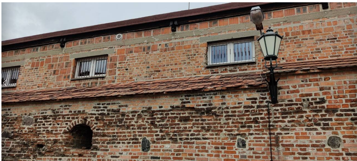
Zdjęcie nr 3.13 Zdjęcie elewacji zewnętrznej – istniejący mur obronny oraz nadbudowa (nowa cegła oraz dachówka karpiówka, widoczne uzupełnienia muru nową cegłą) oraz nadbudowa na murze – pustak ceramiczny/cegła z wieńcem pod oparcie więźby oraz nadprożami monolitycznymi.
