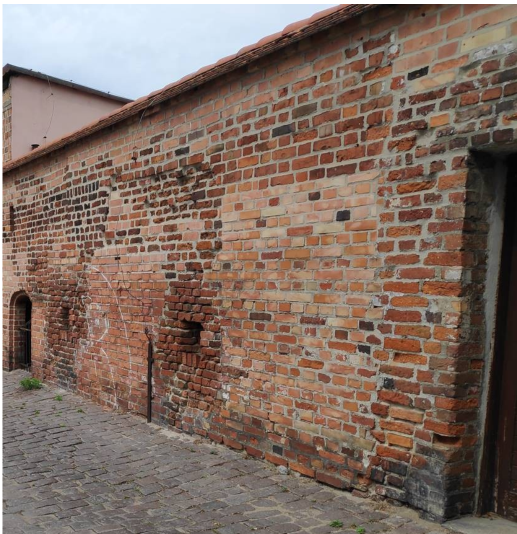
Zdjęcie nr 3.7. Zdjęcie elewacji zewnętrznej – istniejący mur obronny oraz nadbudowa (nowa cegła oraz dachówka karpiówka, widoczne uzupełnienia muru nową cegłą).
