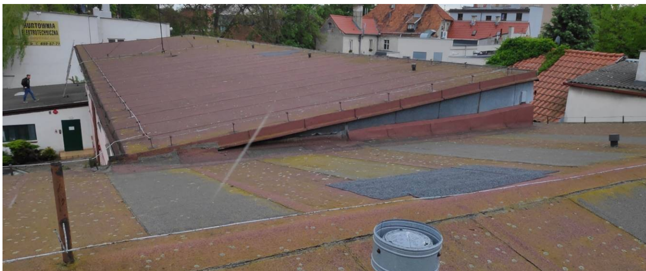
Zdjęcie nr 3.24 Zdjęcie poziomu dachu – widok rozdzielnych konstrukcji dachu oraz wywinięcia obróbek z papy.
