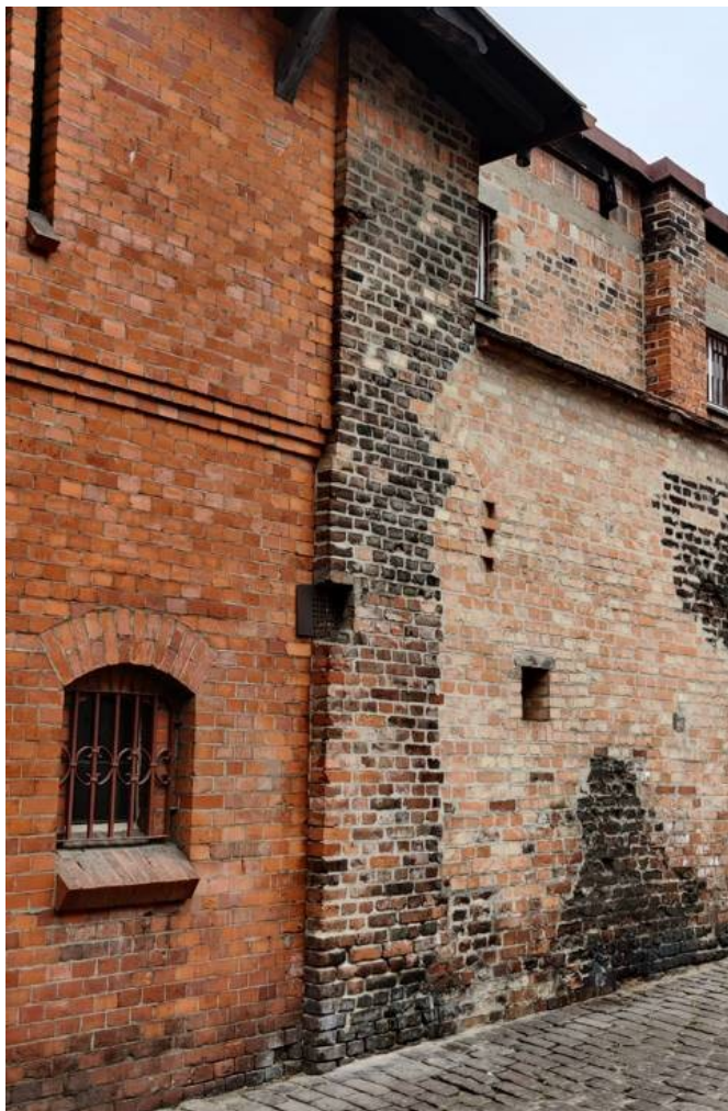
Zdjęcie nr 3.19 Zdjęcie elewacji zewnętrznej – połączenie budynku „A” z zabytkowym murem obronnym i budynkiem „B”. Widoczny uskok na ścianie – brak ciągłości i wiązania muru.
