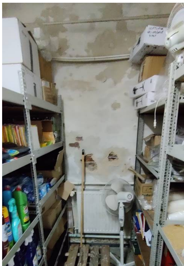
Zdjęcie nr 3.14. Zdjęcie ściany od wewnątrz – parter – widoczne zacieki, odparzenia tynków itp.
