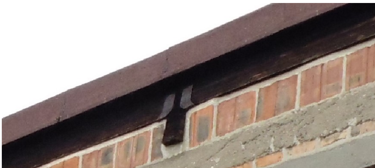
Zdjęcie nr 3.16. Zdjęcie oparcia belki więźby dachowej – oparcie na wieńcu pośrednim oraz mocowania na wspornikach stalowych płatwi poprzecznych.
