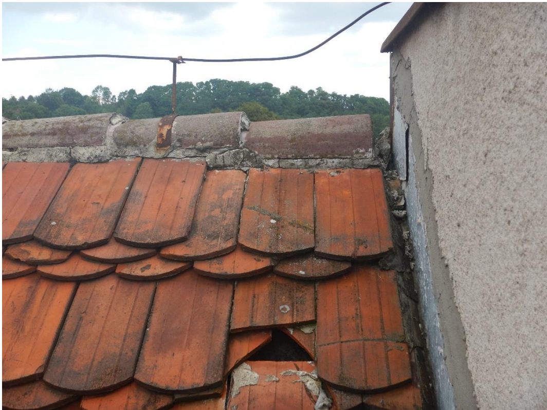
Fot.11 Dach łącznika - ubytki w dachówce
