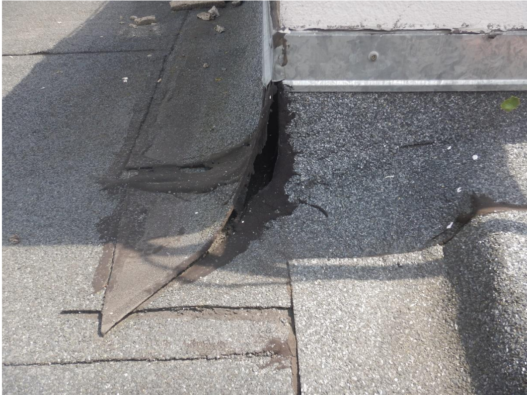
Fot.27 Dach płaski sali - obróbka komina
