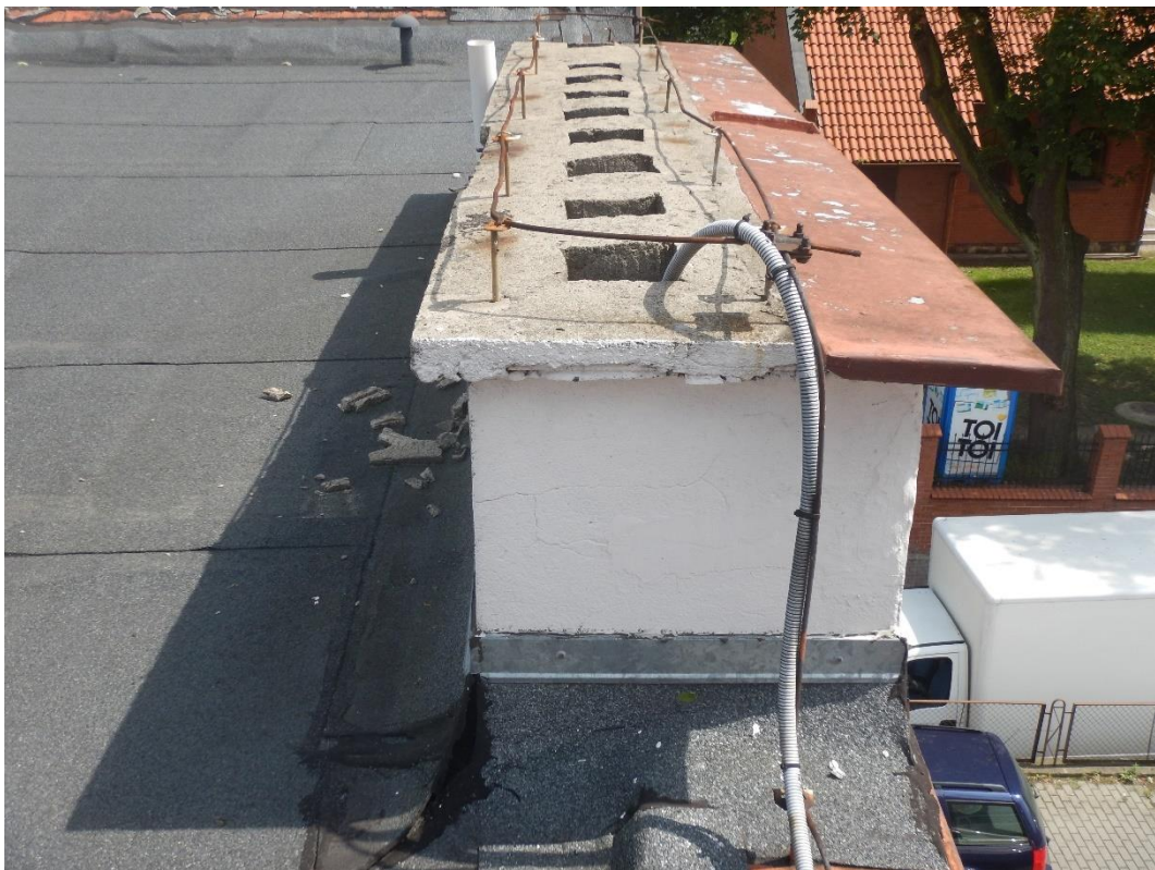
Fot.28 Dach płaski sali - obróbka komina
